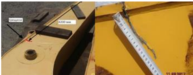
Рис.6. Трещина на стреле экскаватора Komatsu PC1250SP-7
